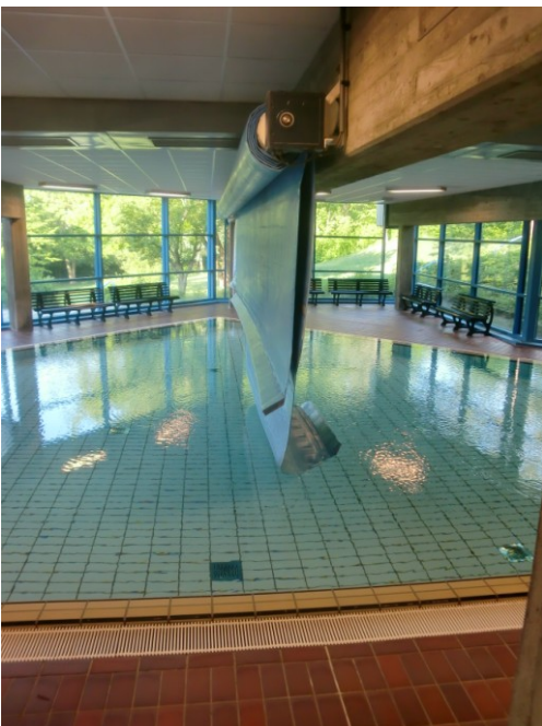
Bild 3 und 4: Abdeckanlage des Nichtschwimmerbeckens
