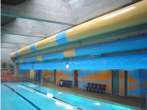
Bild 1 und 2: Abdeckanlage des Schwimmerbeckens
