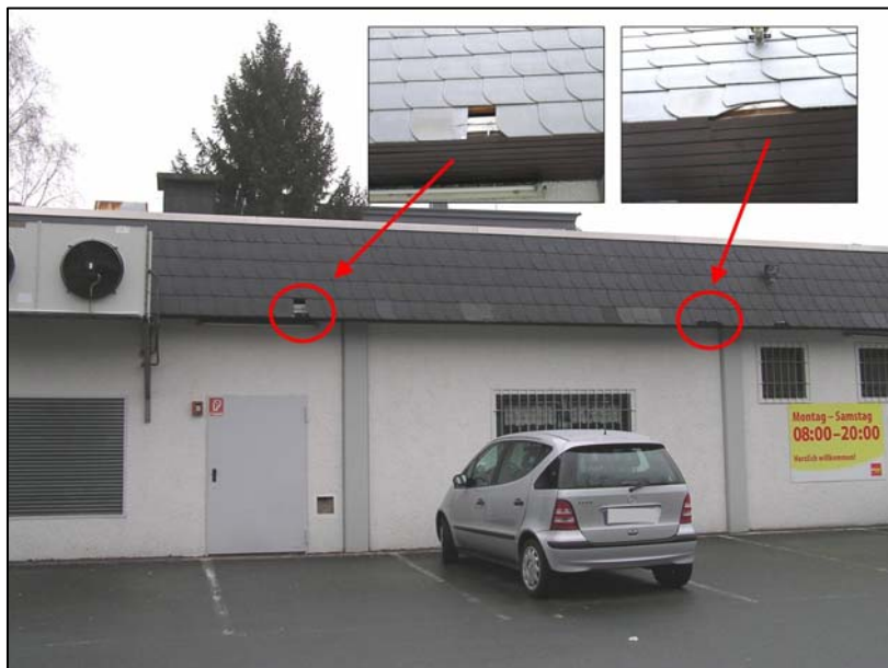
Abb. 4: Zugangsmöglichkeiten für Fledermäuse und Vögel in der Verschindelung am Penny-Markt.
